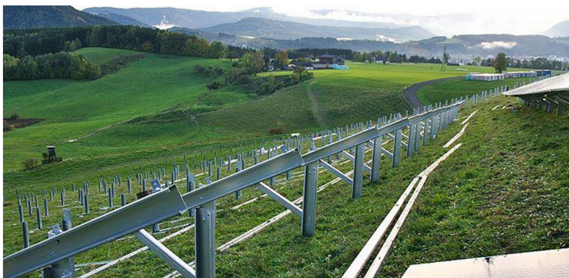
Zdjęcie 3. Konstrukcja przeznaczona do posadowienia paneli fotowoltaicznych.
